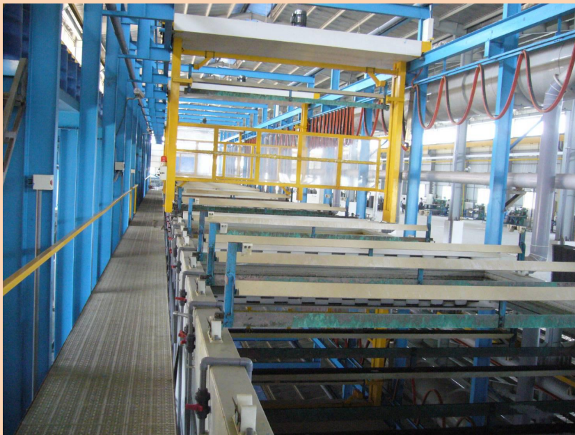
圖-越南佳鉸公司電鍍設備
